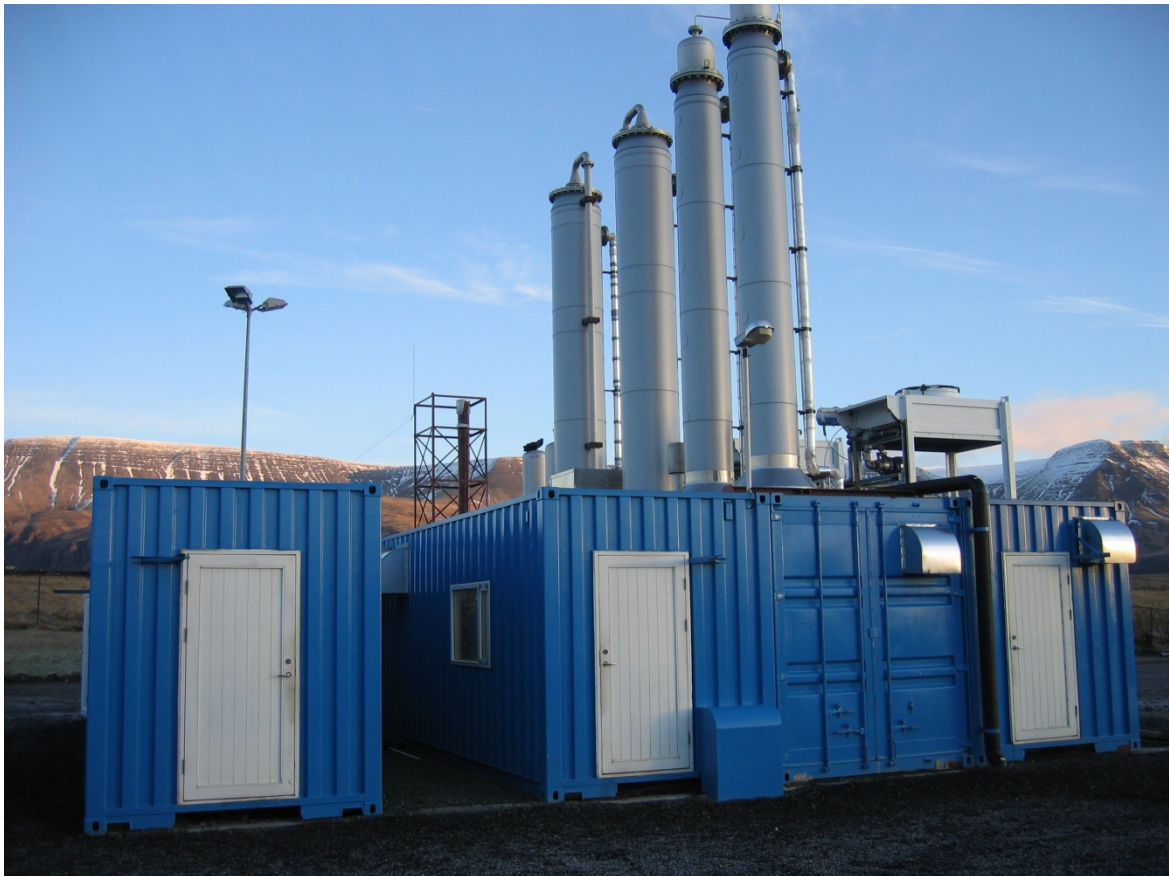
Hreinsistöð fyrir hauggas í Álfsnesi (Ljósmynd: Mannvit)
